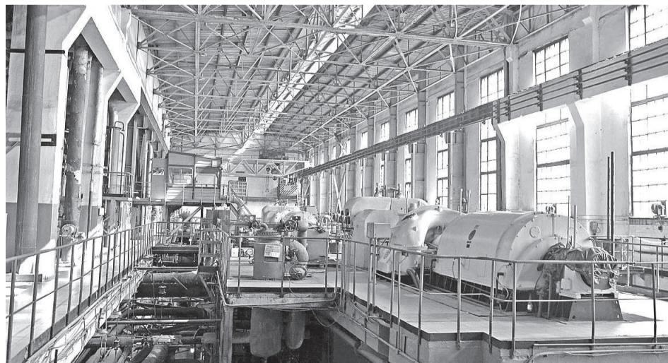
Турбинный зал ТЭЦ
